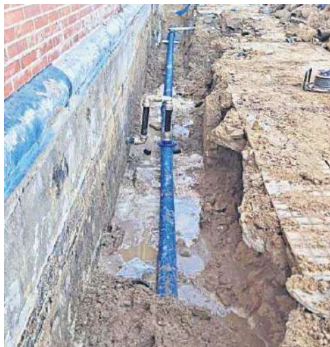
La tubería afectada, en la calle Valdés.
